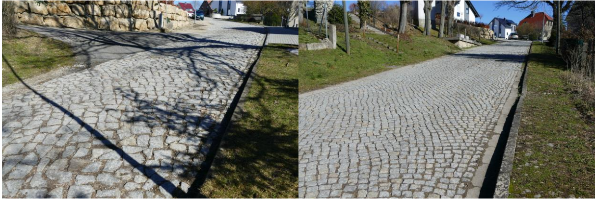
Abbildung 104: Sanierungsbedürftige Wahlstraße, Ortschaft Kefferhausen (Quelle: ProjektStadt 2021)
