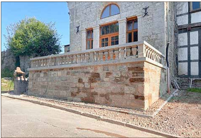
Vorbereitende Arbeiten: Rückbau- und Sicherungsmaßnahmen am erhaltenswerten Gebäudebestand sicherten die Grundlage für den Neubau.
