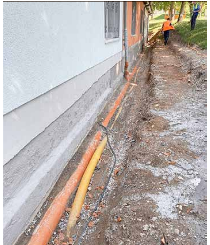
Sanierung der Außenwände und Fundamente: Loser Putz wird entfernt, um die Außenwände und Fundamente für die weiteren Arbeiten vorzubereiten.
