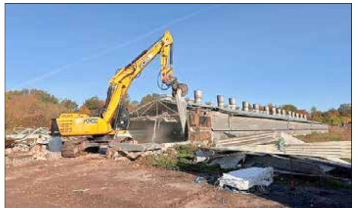
Für die Wasserversorgung werden moderne GGG-Trinkwasserleitungen verlegt und eine 200 m 3 große Löschwasserzisterne wird gebaut. Die Entwässerung erfolgt durch getrennte Schmutz- und Regenwasserkanäle. Ein Regenrückhaltebecken mit 500 m 3 Kapazität und zusätzliche Maßnahmen zur Regenwasserbehandlung sowie Versickerung garantieren einen umweltgerechten Umgang mit Wasser.
