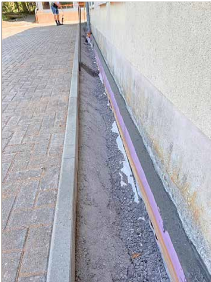
Anschluss an das Kanalnetz: Der Anschluss an das öffentliche Kanalnetz ersetzt die bisherige Abwasserlösung.
