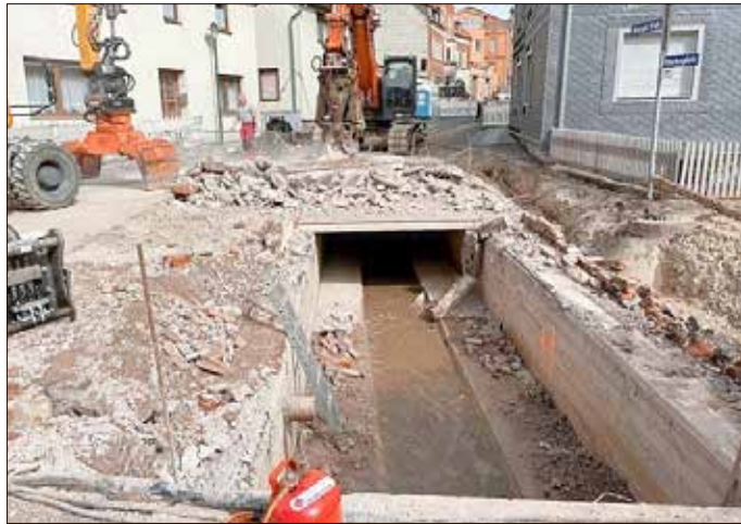
Die Flutgrabenbrücke in der Birkunger Straße, ein wichtiger Bestandteil der Dingelstädter Infrastruktur, wurde erfolgreich saniert.
